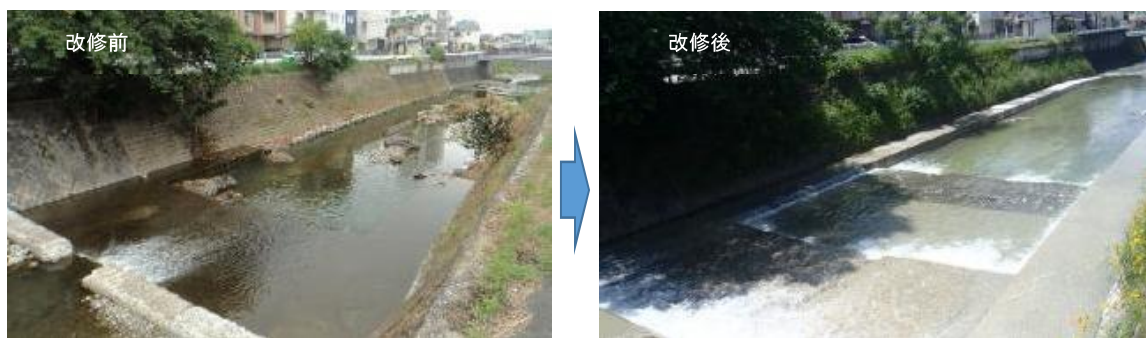
写真-3.26 護岸・河床改修例 千里川(豊中市本町九丁目) (左：改修前、右：改修後)
