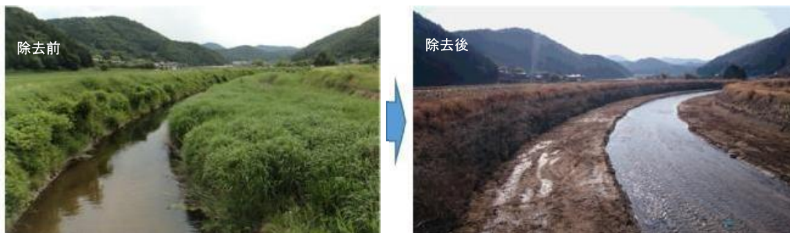
写真-3.25 河道の堆積土砂除去例 一庫・大路次川(能勢町宿野) (左：除去前、右：除去後)
