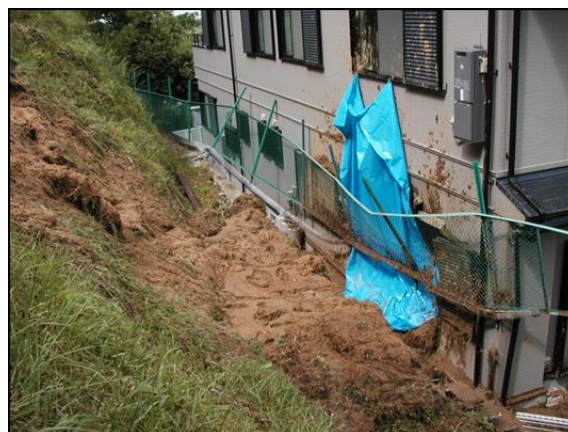
写真参 1-3 がけ崩れ災害 (H16・畑(8)地区)
