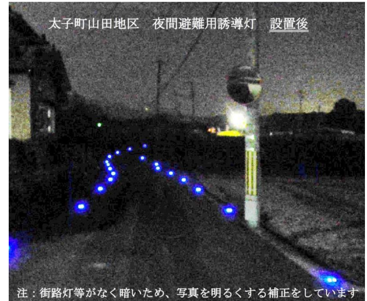
夜間誘導灯の設置（モデル地区）
