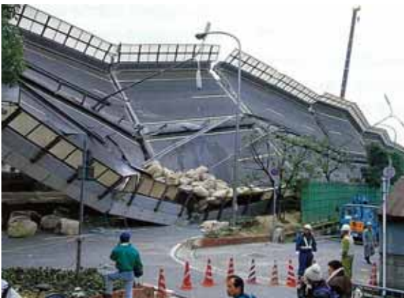
【 図2-40：道路の被災状況 】
