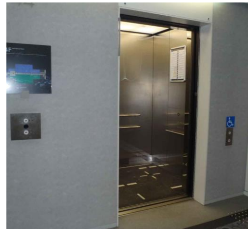
長周期振動センサーが作動すると最寄階に停止し扉が開放。
