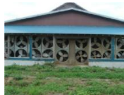
畜舎壁面の換気扇
