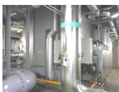
高効率タイプの冷温水機
