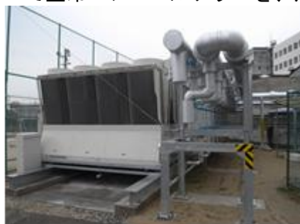
空冷モジュールチラー（総合研究所、更新後）
