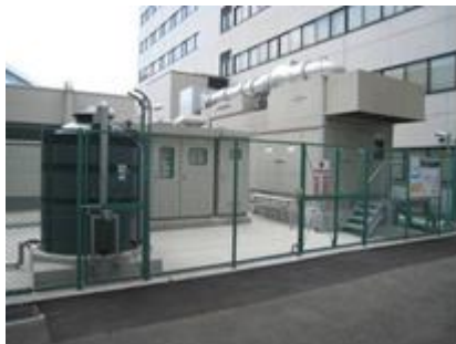
コージェネレーションシステム（総合研究所、更新後）
