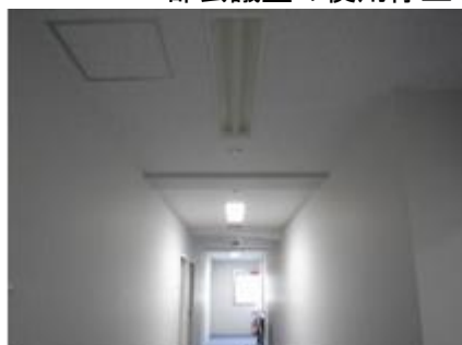
大阪総合センター 廊下照明の間引き
