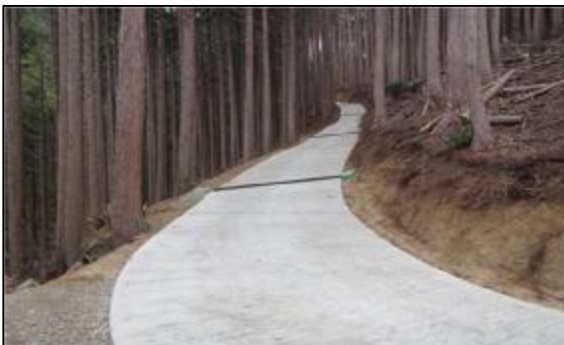
効率的な木材搬出のための基幹作業道舗装化（千早赤阪村水分地区）
