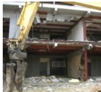
飛散防止対策が不十分なまま無届で実施した不適正な解体工事の例
