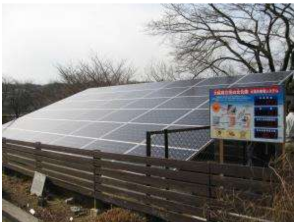
太陽光発電施設
