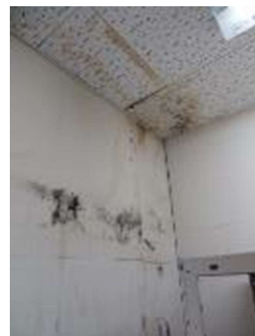
センター棟2階倉庫内の雨漏りの跡
