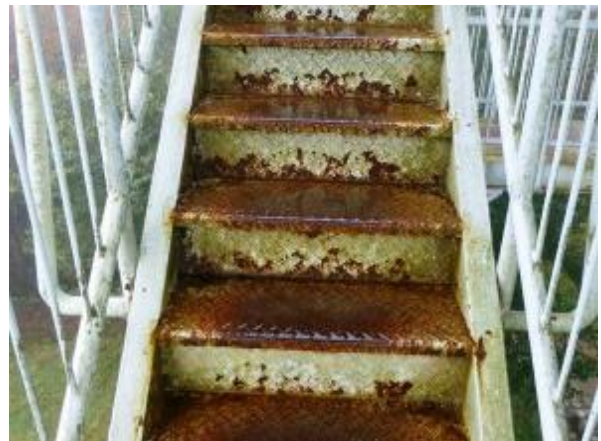
老朽化による腐食 (展望台)
