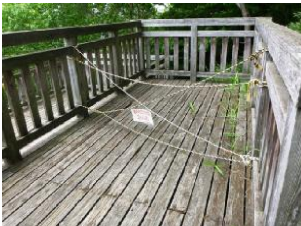
老朽化による破損 (展望台)
