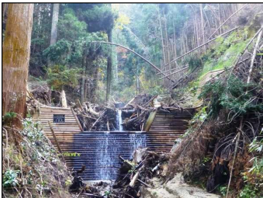
〔土石流を抑止した治山ダム〕 災害抑止時や経年劣化によりコンクリートが 損傷
