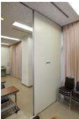
研修室の可動間仕切り（動かない）
