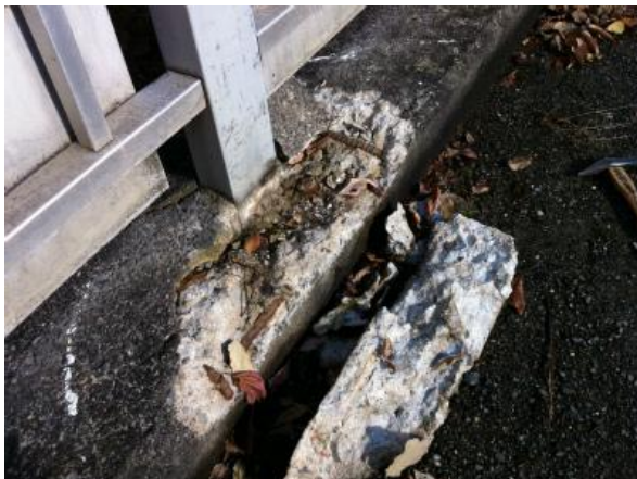
老朽化による高欄基礎 Co の破損 (橋梁)
