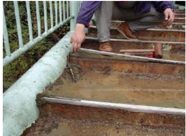
老朽化による腐食 (橋梁)
